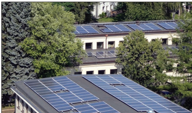
System PV w Łodzi o mocy 450 kWp
