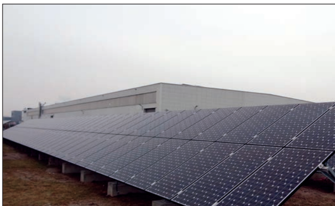
System PV w Żarowie o mocy 220,84 kWp
